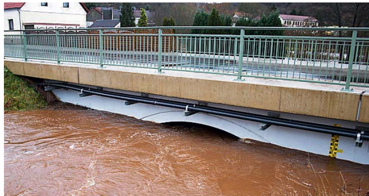
Der Todbach in Balterweiler schwillt an und erreicht fast den oberen Teil der Brücke.
