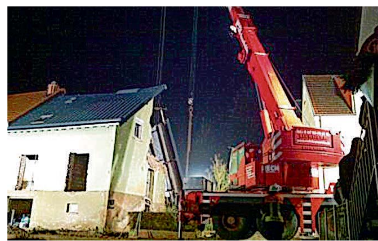
In der Nacht auf Mittwoch hoben Spezialisten mit Spezialkränen das Dach des teils zusammengebrochenen Hauses ab.
