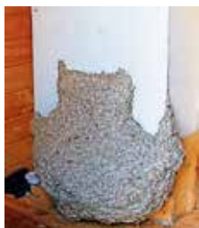
Das am Schaltschrank haftende Wespennest (links) schaffte ein Feuerwehrmann vorsichtig mit einer Schaufel ins Freie. FOTOS: FFW
