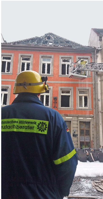
Baufachberater Thomas Rahn vom St. Wendeler THW blickt auf das stark verwüstete Gebäude samt Kneipe. FOTO: THW/MARKUS TRÖSTER
