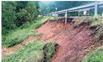
Verbindungsstraße L 133 zwischen Dirmingen und Berschweiler: Die Strecke ist nach der Sintflut gesperrt. FOTO: DIRK SCHÄFER
