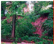
Unterspülte Hänge werden zur Gefahr für die Häuser, die auf der Anhöhe stehen. FOTO: FABER
